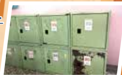
未整修前置物櫃老舊破損
